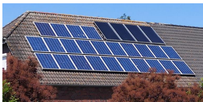
Abbildung 39: Solarthermische und Photovoltaische Nutzung von Dachflächenanlagen (B.A.U.M. Consult, 2021)
